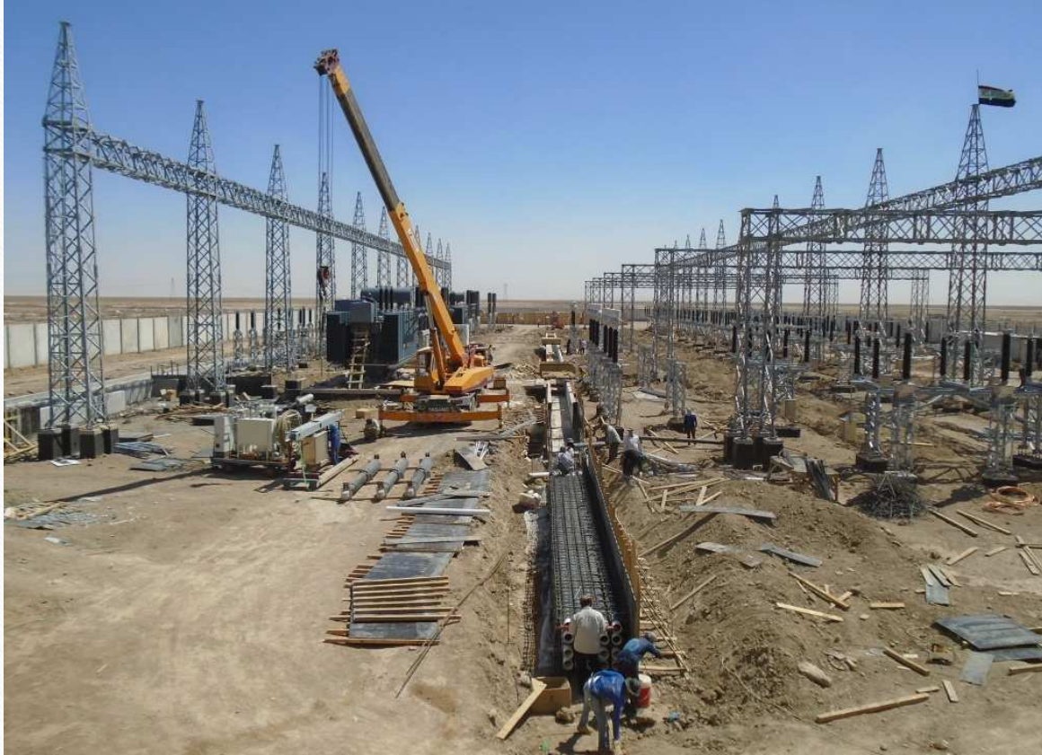
Trafo Merkezi Fotoğrafları
