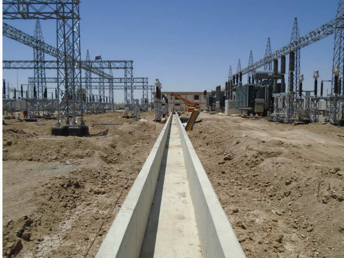
Trafo Merkezi Fotoğrafları
